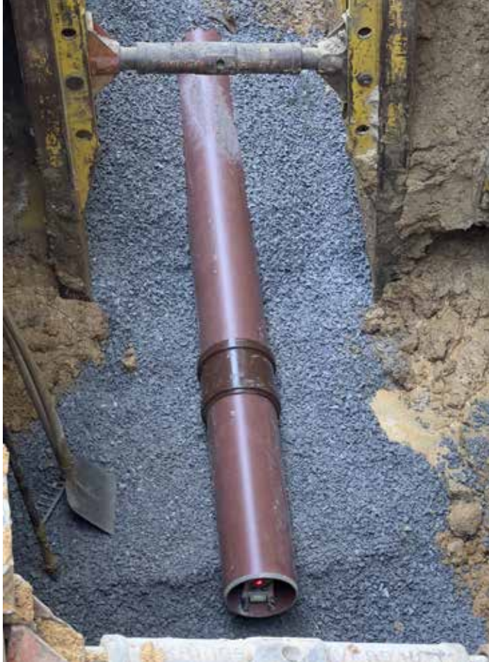
Das HS®-Rohr wird mit Blick auf Lage und Höhe auf der Bettungsschicht ausgerichtet. Foto: Funke Kunststoffe GmbH
