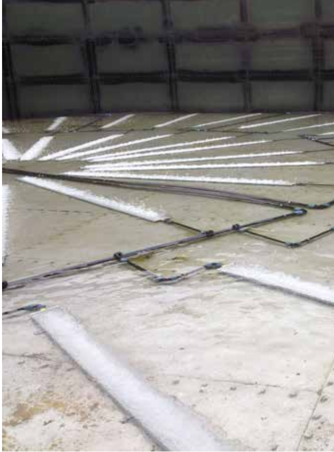
Schon 2013 wurden in einem Belebungsbecken der Kläranlage 50 AEROSTRIP Streifenbelüfter installiert. Die erzielten Energieeffizienz- und Performanzwerte überzeugten die Anlagenbetreiber auch für die Aufrüstung des zweiten Belebungsbeckens. © AQUACONSULT
