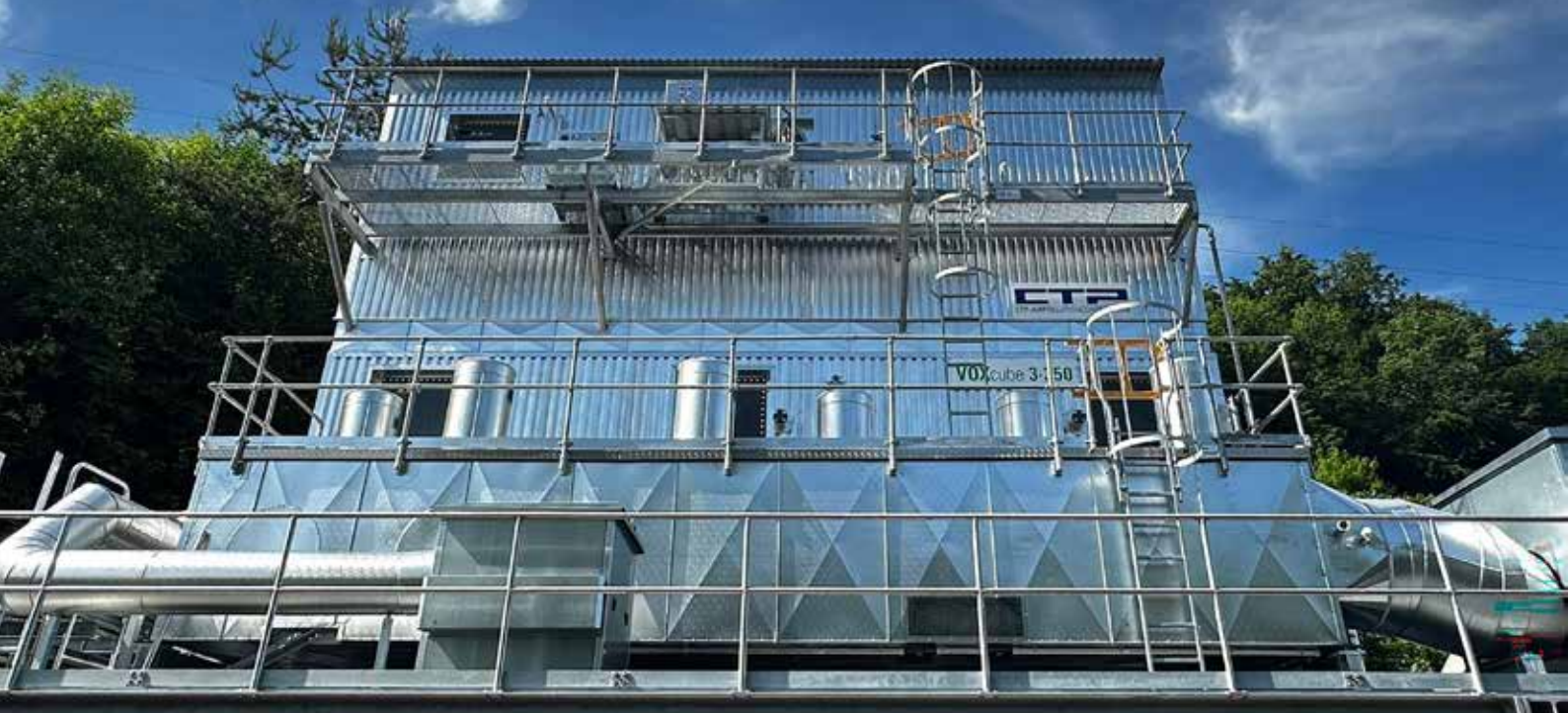
Die Regenerative-Thermische-Oxidationsanlage (RTO) von CTP in der ARA Bern: Über 95 % der Lachgas-Emissionen werden hier effizient zerlegt und neutralisiert.
