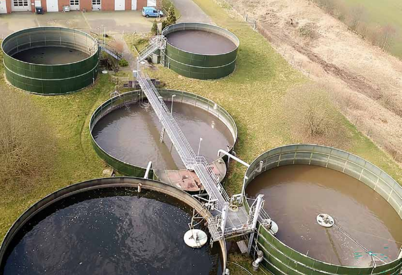
Die Kläranlage Hanerau-Hademarschen rüstet sich mit weiteren AEROSTRIP Streifenbelüftern, um die Spitzenbelastungen während des sommerlichen Heavy Metal Festivals im nahe gelegenen Wacken zu bewältigen. © Wasserverband Süderdithmarschen
